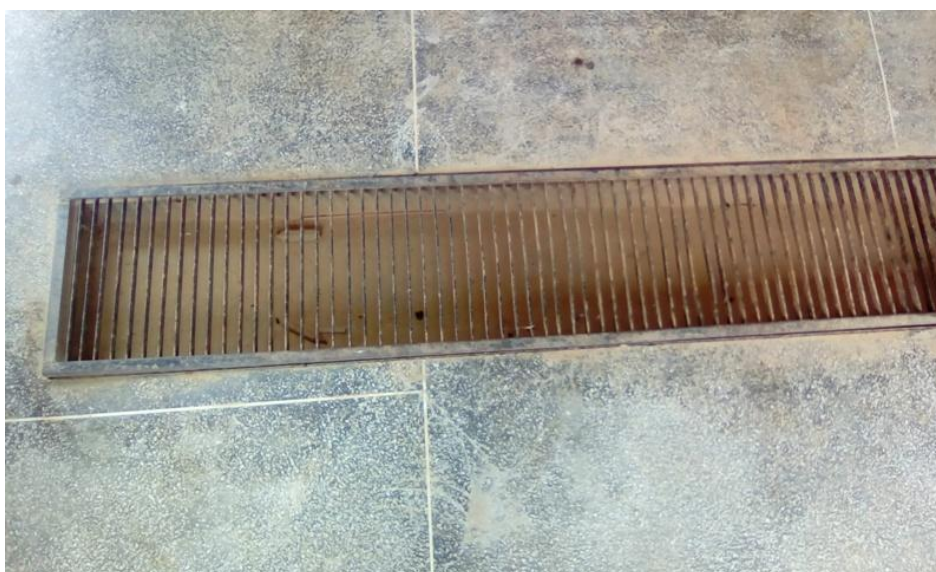
Figura 16 – Inadequação da estrutura de armazenamento de resíduos Hospital Regional de Salgueiro
