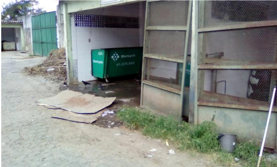
Figura 4 – HGV- Porta em má conservação e presença de vetores: pombo
