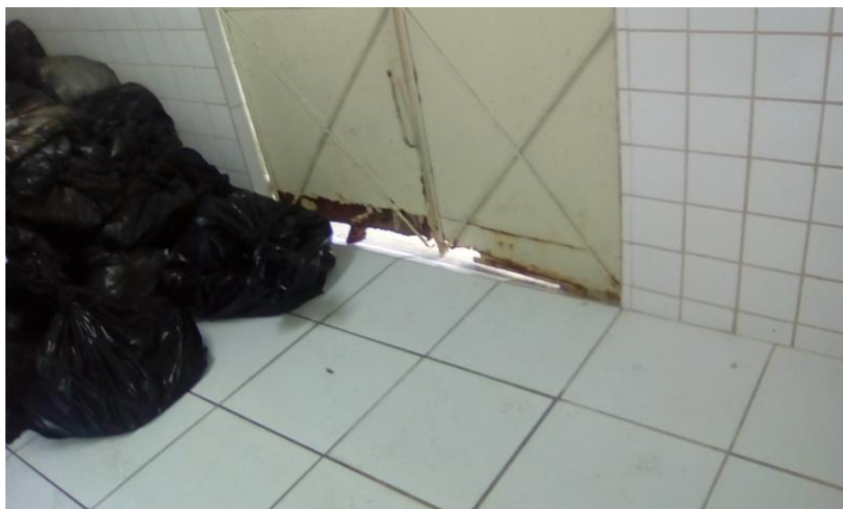
Figura 12 – Porta inadequada para proteção Hospital e Maternidade Jesus Nazareno
