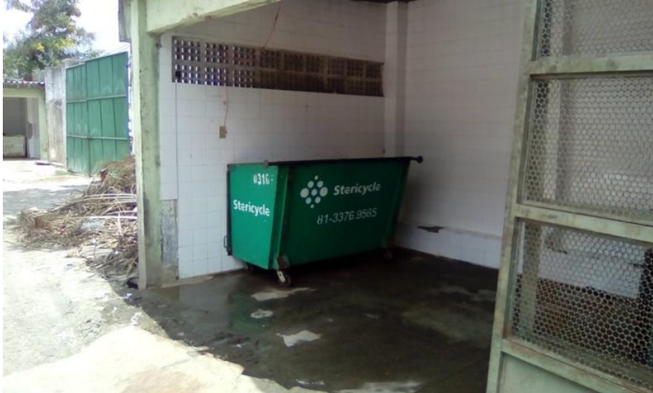
Figura 2 – HGV – Abrigo sem porta nem canaleta
