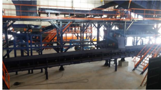
Estação de Transbordo em Paulista – Maquinário para separação dos resíduos
