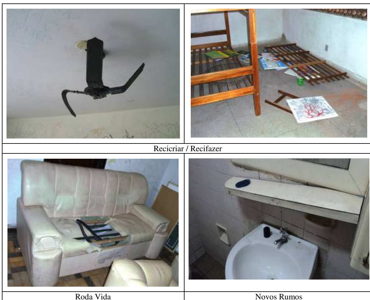
Figura 4 – Depredação dos equipamentos pelos usuários outubro/2010
